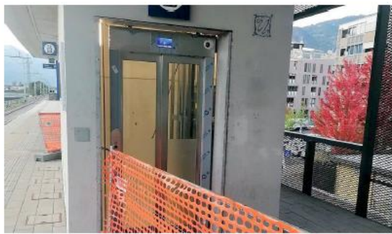
Nella stazione di Casanova l'ascensore è rotto da tempo
